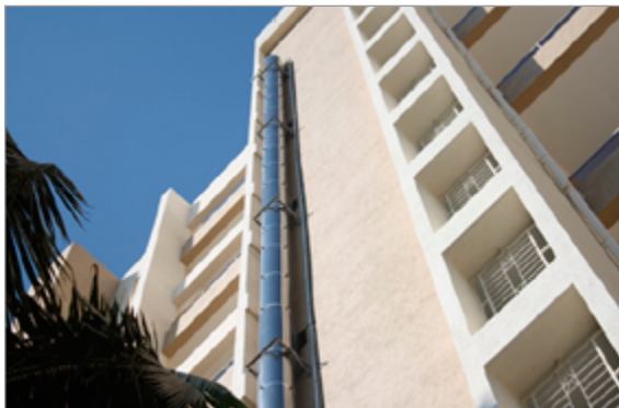
AFBEELDING 3.16: EEN STORTKOKER AAN DE BUITENKANT VAN EEN GEBOUW.
